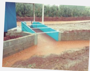
Calha H foi instalada nas lavouras
