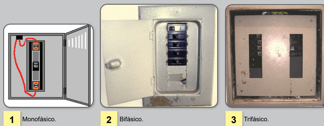
Figura 12 – Quadros de distribuição.
