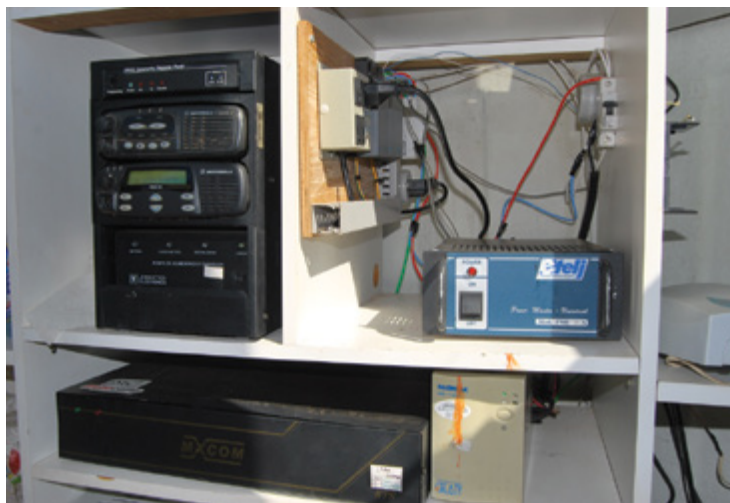
Figura 46 – Equipamento de comunicação na torre de observação.
