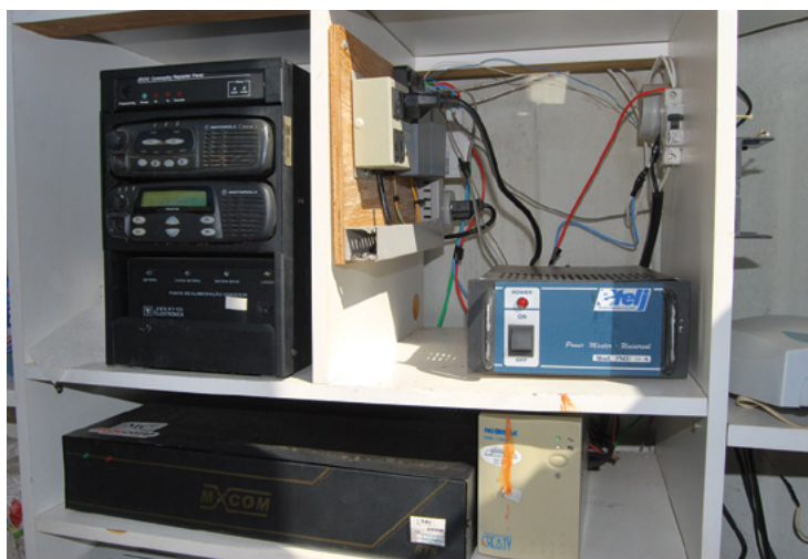
Figura 46 – Equipamento de comunicação na torre de observação.
