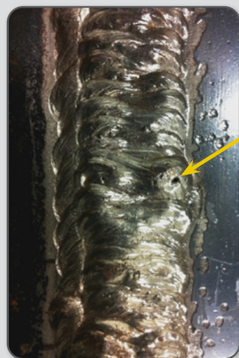
Figura 14 – Presença de porosidade na solda.
