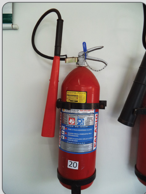
Figura 2 – Modelo de extintor de incêndio que deve estar presente nas áreas de soldagem.
