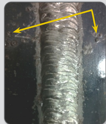
Figura 16 – Defeitos em função da dificuldade de abertura de arco durante a soldagem.
