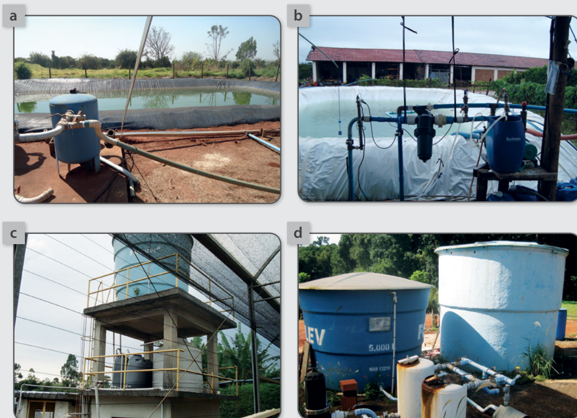
Figura 17 – Tanques para armazenamento de água das chuvas confeccionados com material impermeável de cor preta (a) e branca (b) e reservatórios para armazenamento de água tratada (c) e (d).
