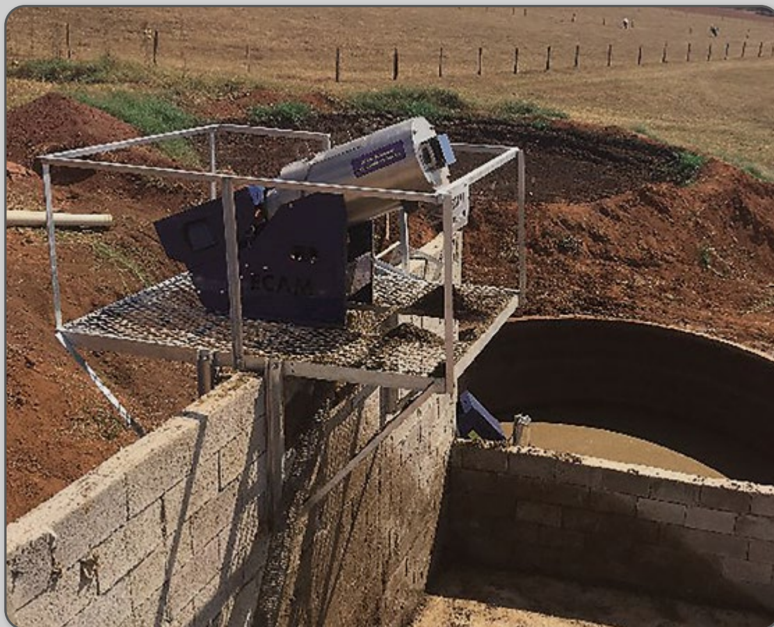
Figura 63 – Conjunto separador de sólidos instalado em plataforma.
