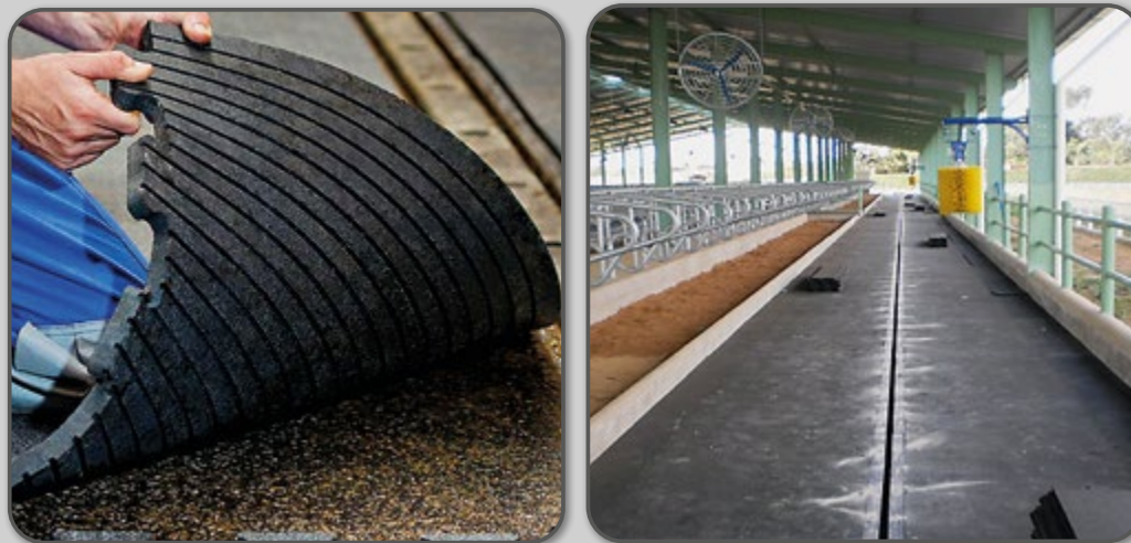
Figura 39 – Piso de borracha em galpão free stall .
