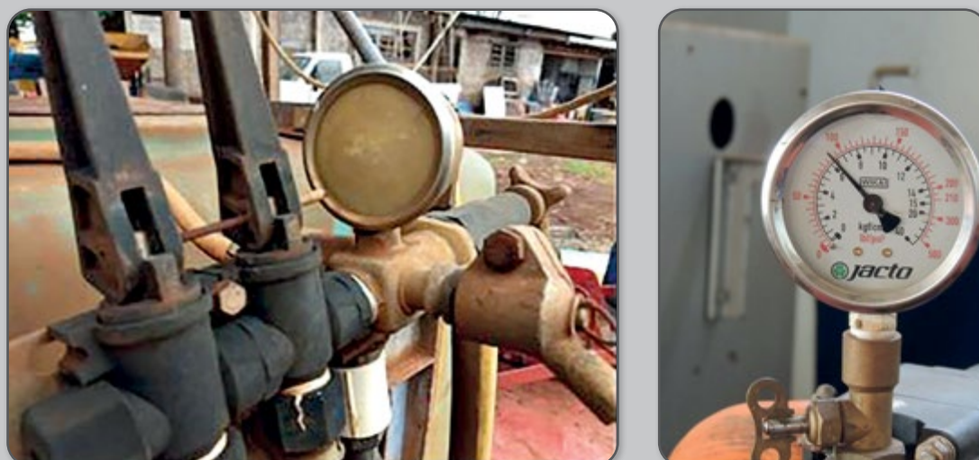
Figura 64 – Manômetro operacional e manômetro não operacional.
