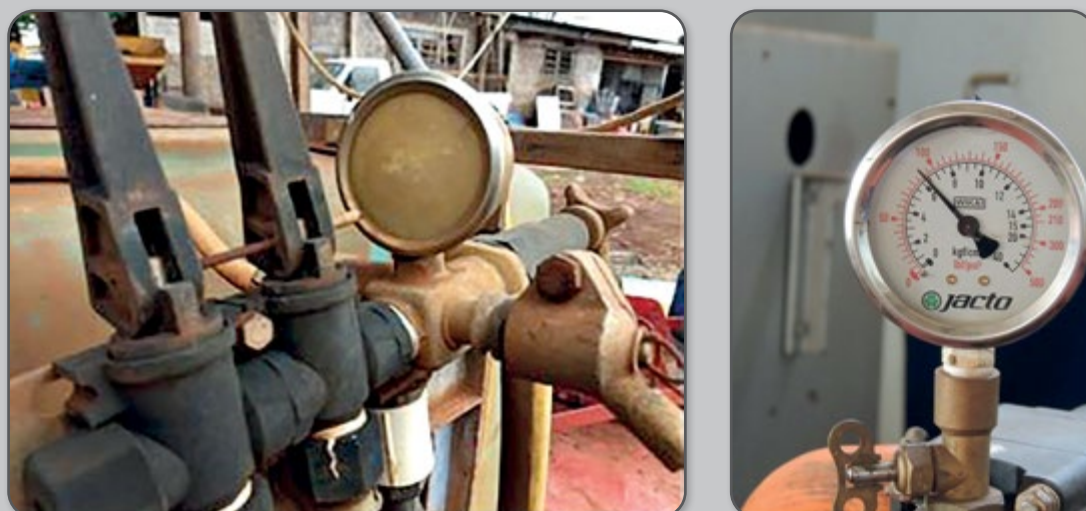
Figura 64 – Manômetro operacional e manômetro não operacional.
