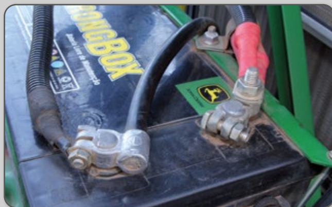
Figura 114 – Terminal e borne em boas condições.
