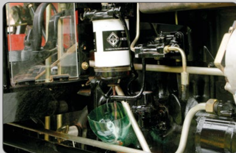
Figura 34 – Escoamento do diesel pelo bujão de drenagem inferior.
