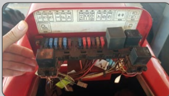
Figura 124 – Caixa de fusíveis.
