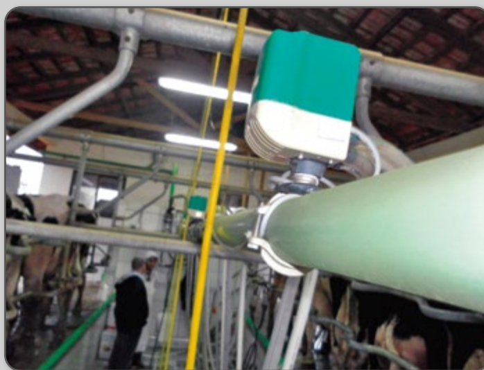
Figura 23 – Tubulação de pulsadores.
