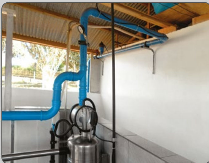
Figura 22 – Tubulação de vácuo.
