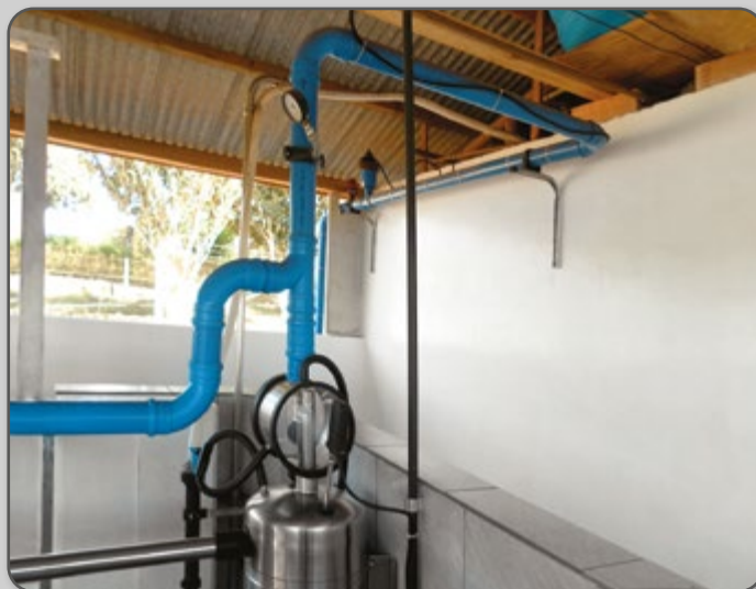
Figura 22 – Tubulação de vácuo.
