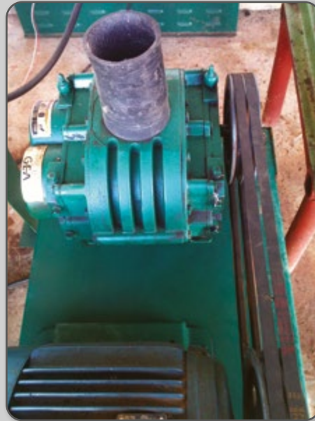
Figura 17 – Alinhamentos das correias.
