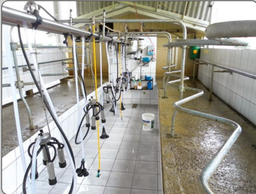
Figura 25 – Tubulação de leite.
