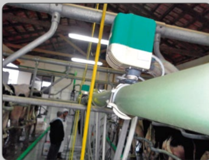
Figura 23 – Tubulação de pulsadores.
