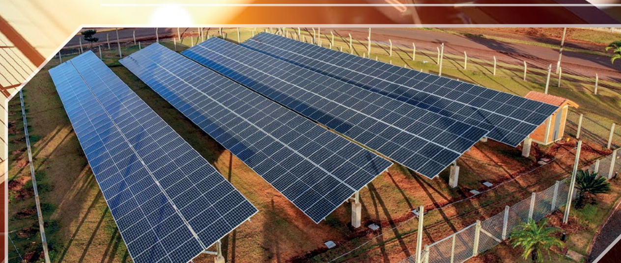
Usina Solar Nelson Paludo, no CTA de Assis Chateaubriand
