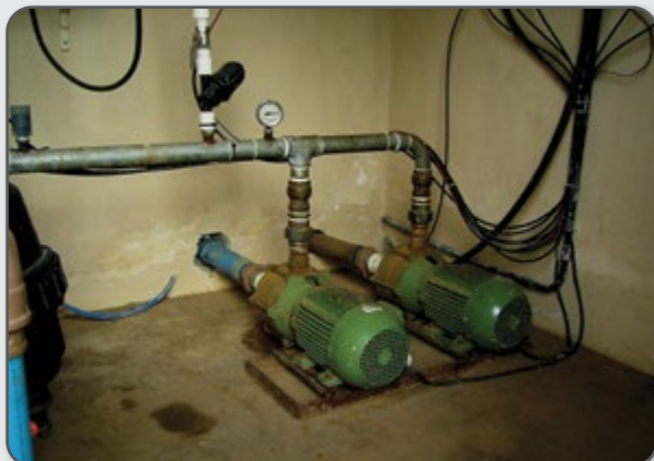
Figura 12 – Exemplo de um conjunto motobomba elétrico.
