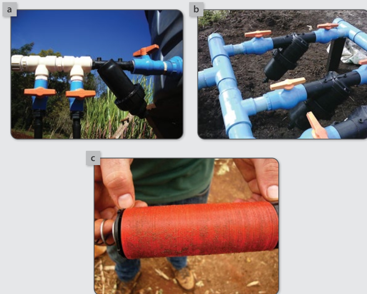
Figura 24 – Componentes do cabeçal de controle do sistema de irrigação localizada. (a) e (b) conjunto de filtros, registros e válvulas; (c) filtro de disco.
