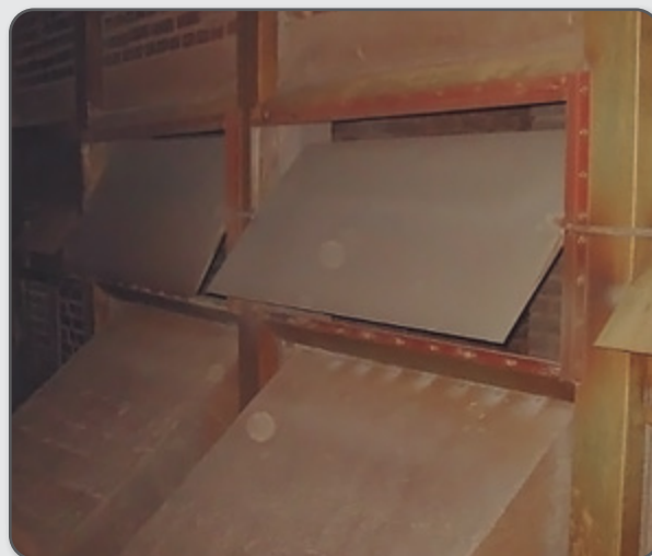
Figura 35 – Registro de ar entre fornalha e secador.
