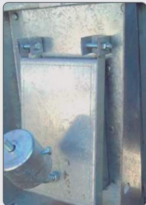
Figura 90 – Cabeça de acionamento de transportador de corrente com tampa de alívio.
