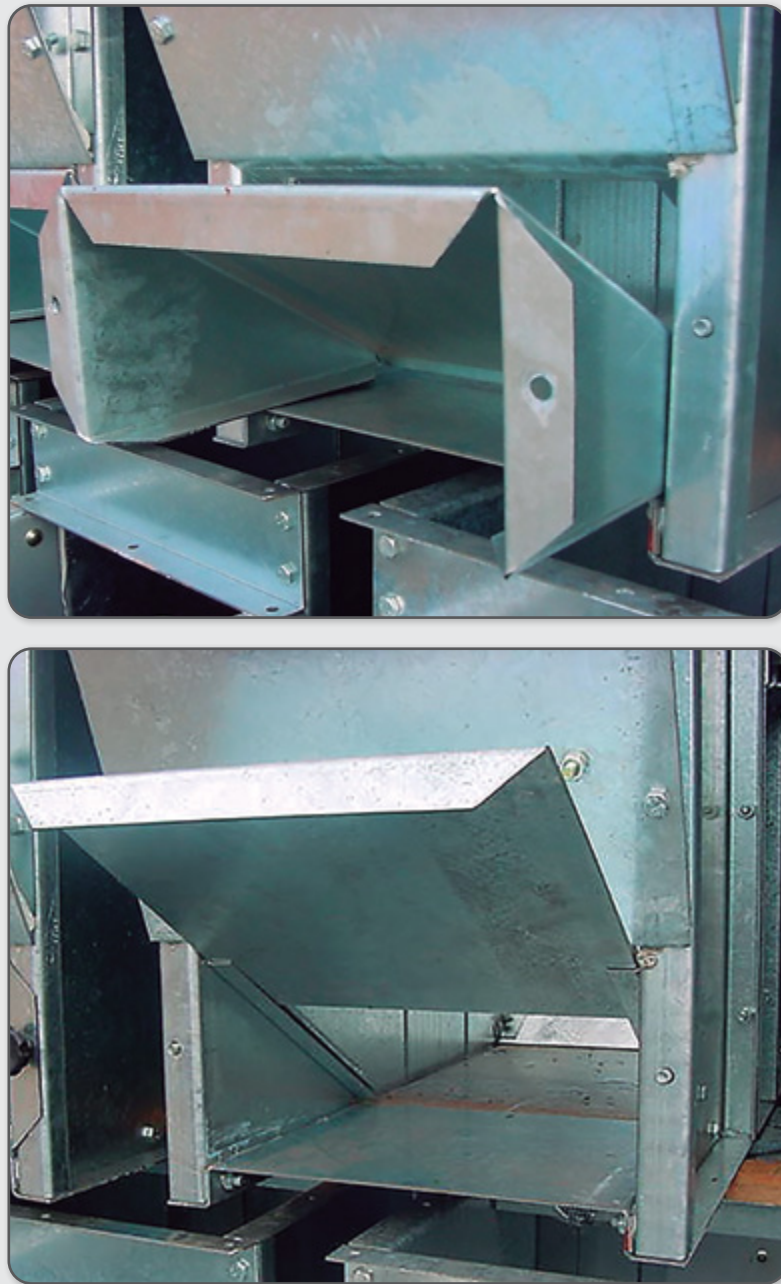
Figura 104 – Linguetas de limpeza no pé do elevador.
