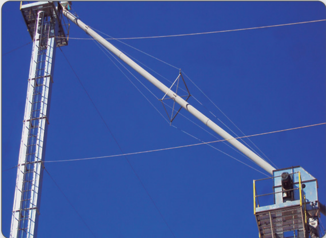
Figura 49 – Canalização com estaiamento.
