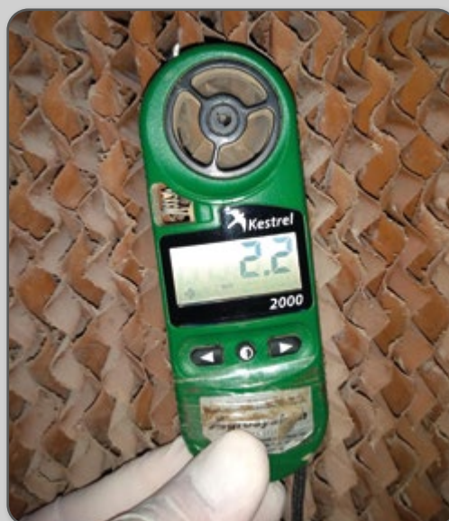
Figura 35 – Indicação de passagem de ar na placa com alta velocidade.
