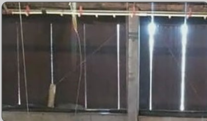
Figura 45 – Entradas de ar indesejadas entre as placas.
