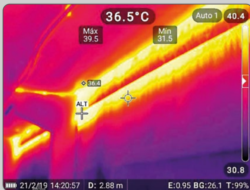
Figura 46 – Falhas na vedação.
