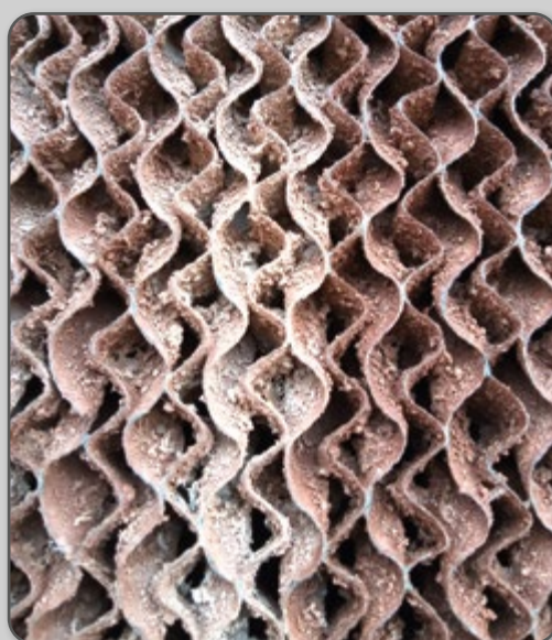
Figura 36 – Placa evaporativa suja com obstrução da passagem de ar.
