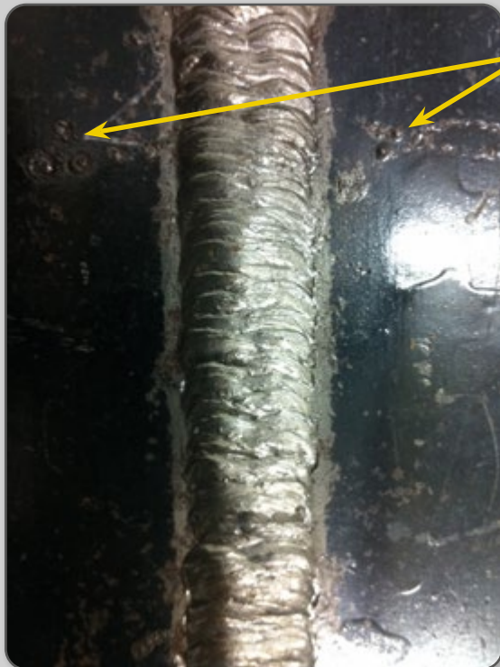
Figura 20 – Solda apresentando problema na abertura de arco.
