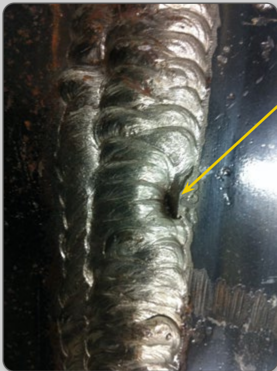
Figura 19 – Solda apresentando o defeito de deposição insuficiente.
