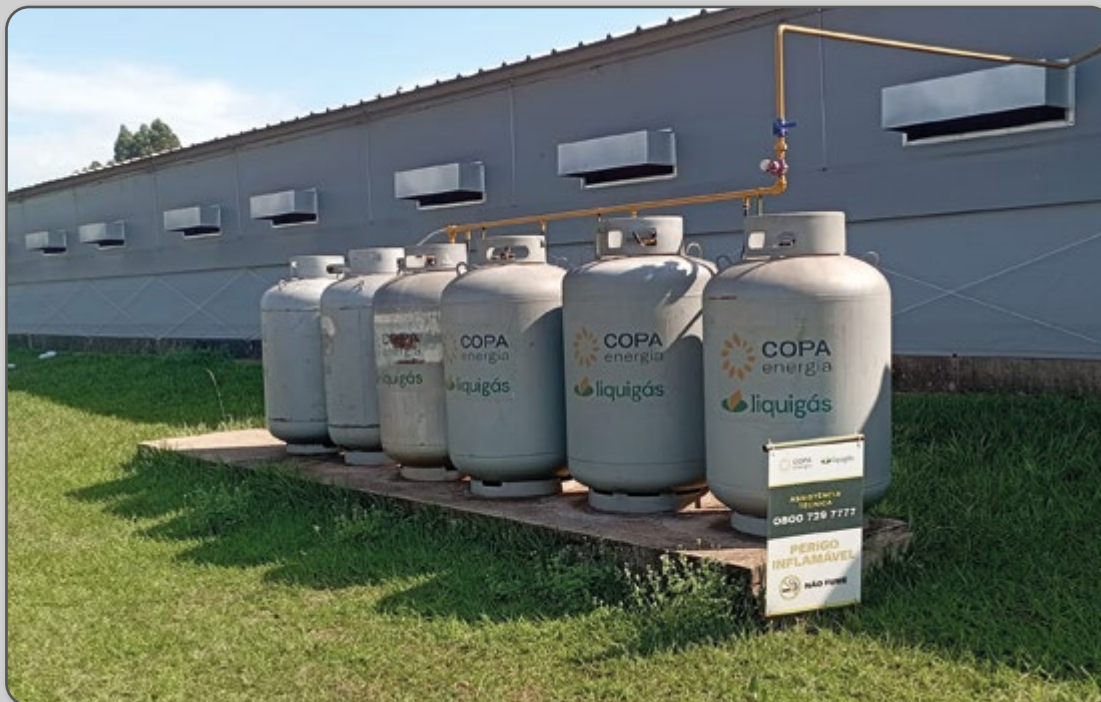
Figura 67 – Reservatório de gás.
