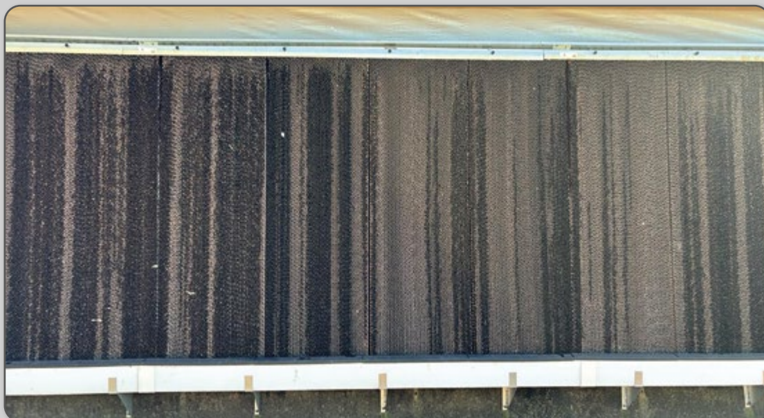
Figura 72 – Sistema de irrigação da placa evaporativa entupido.
