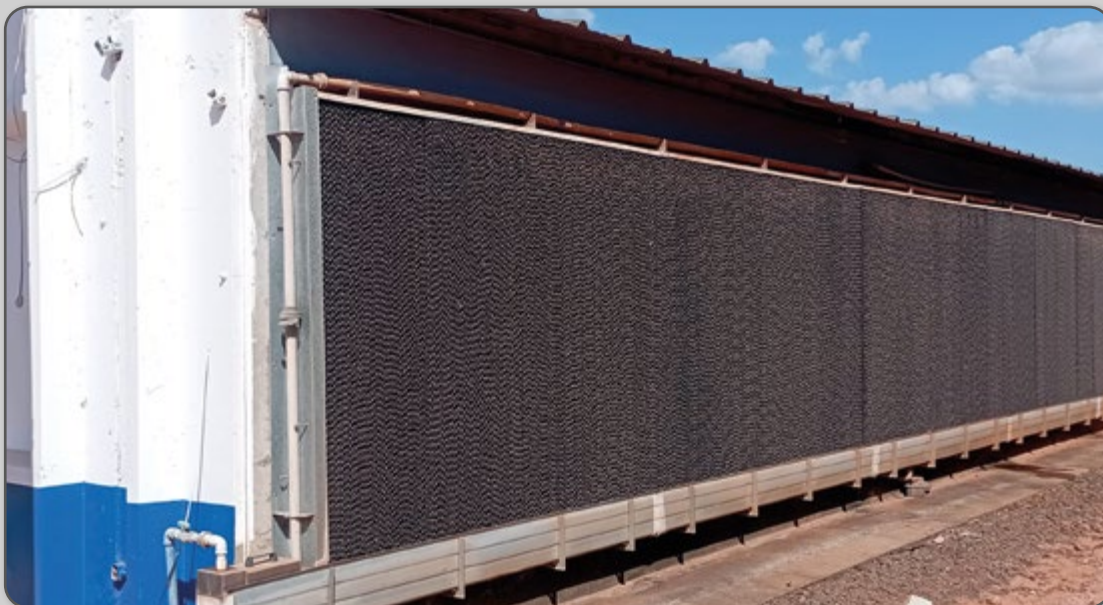
Figura 70 – Entrada de ar com placa evaporativa.
