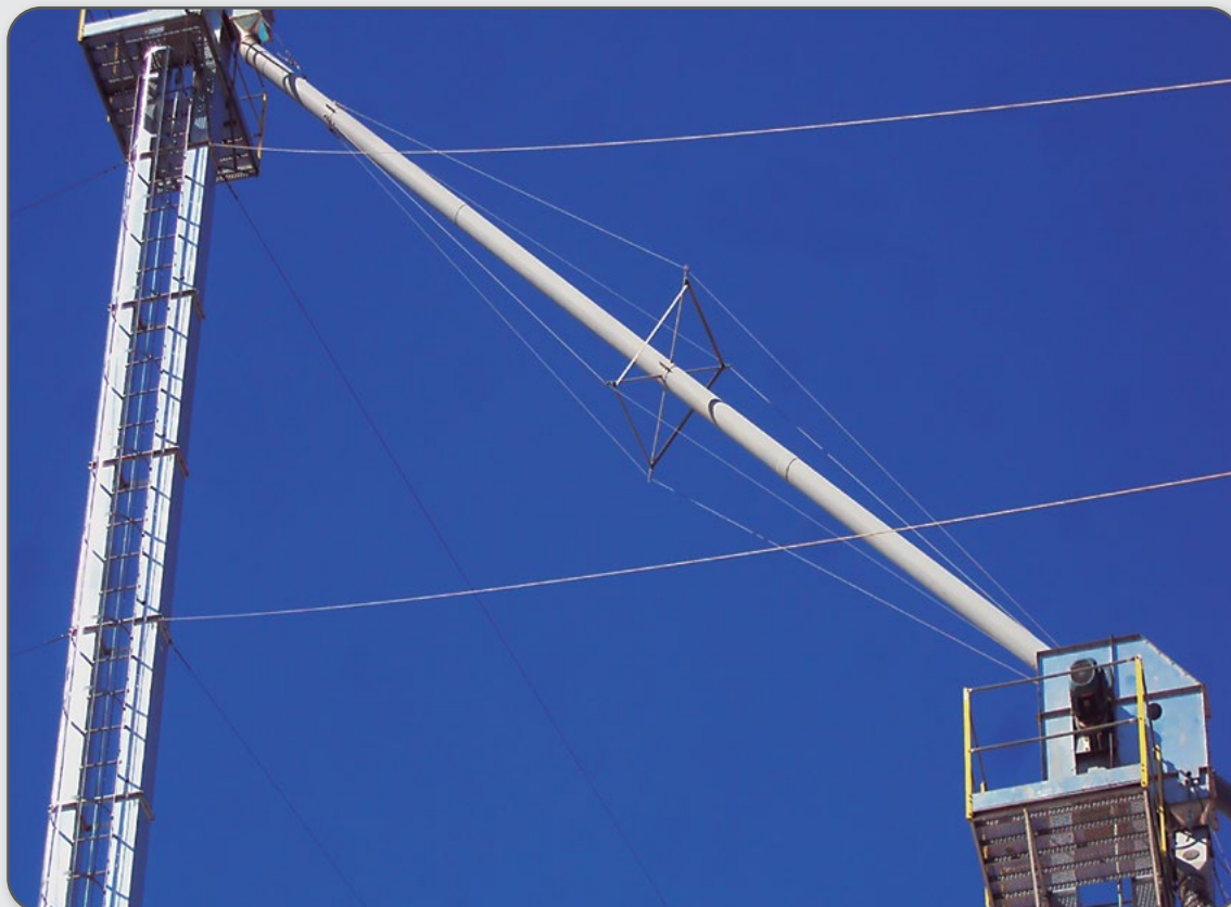
Figura 49 – Canalização com estaiamento.
