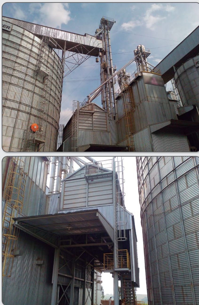
Figura 110 – Exemplo típico de tulha de expedição metálica.
