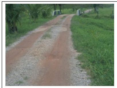
Cascalho em área de circulação
