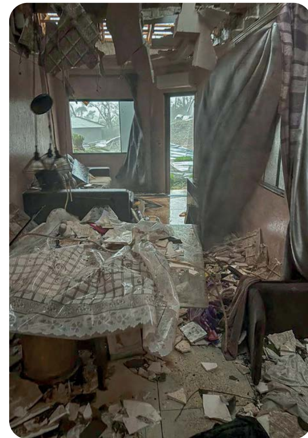
▼ Até mesmo residências foram danificadas pelo tornado
