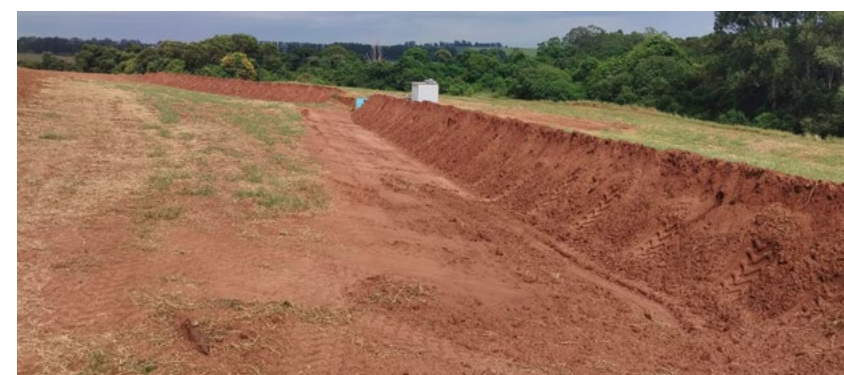
▲ O terraço diminui o comprimento de rampa e impede o escoamento de água, solo e nutrientes
